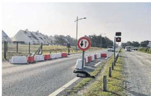
Rien n'est prévu pour les vélos sur le rétrécissement boulevard Belmont
