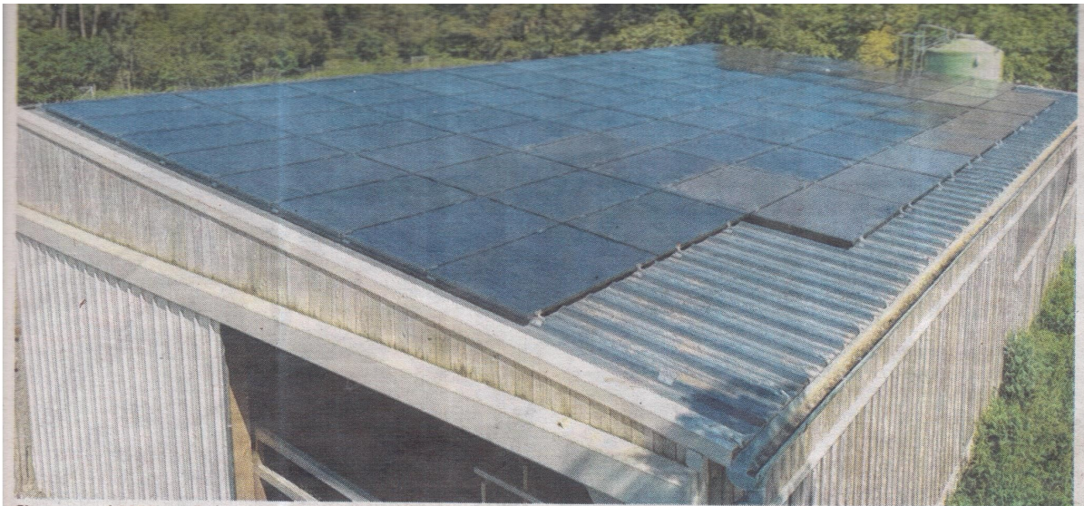
C'est en mai 2022 que la centrale photovoltaïque a été installée sur l'un des poulaillers du Bois de Bouille
